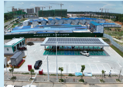
环新英湾区光储超充 一体化示范站
